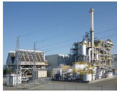
木質バイオマス発電所 日田発電所
